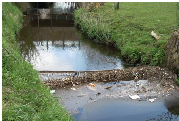
Figuur 6: Het gemeentelijk overstort, stroomopwaarts van de vangstconstructie & Vuilroosters stroomopwaarts van de vangstconstructie. Zicht op de hoeveelheid zwerf- en drijfvuil twee dagen na de laatste reiniging.
