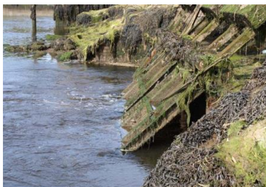
Figuur 7: voorbeeld van uitwateringskleppen die zijn uitgerust met een tegengewicht bovenaan de klep.
