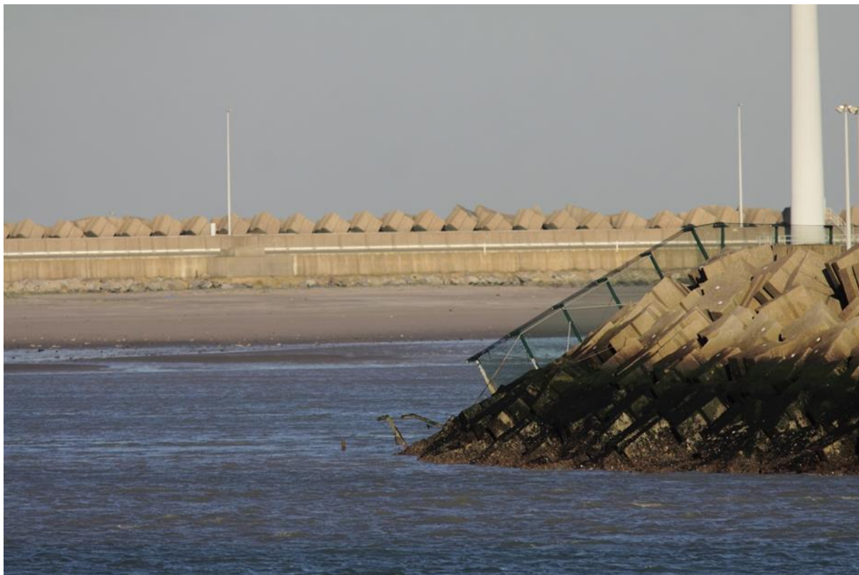
Figuur 5. Deze foto toont de toestand van het hek aan de LNG-dam in december 2012.
