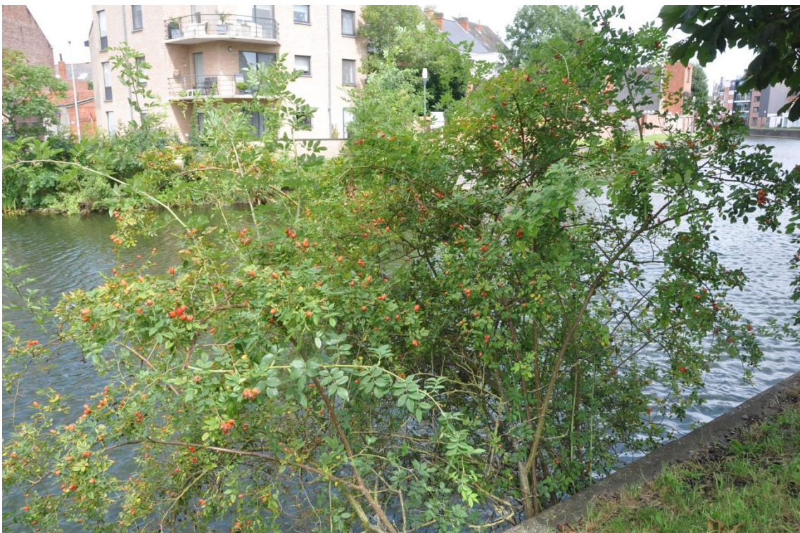
Figuur 16: Een fors uitgegroeide hondsroos die zich onder de deksteen van de kaaimuur genesteld heeft en schade aan de stabiliteit van de toplaag van de kaaimuur kan veroorzaken.
