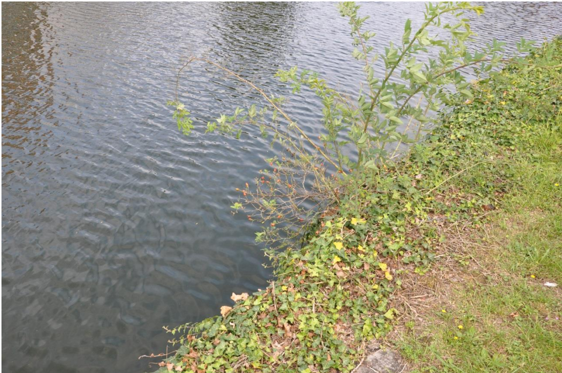
Figuur 14: Klimop en gewone vlier , beide soorten die met hun houtige wortels schade kunnen veroorzaken aan de kaaimuur.
